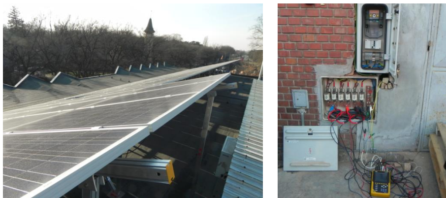
SLIKA 5 – FN paneli na krovu (levo) i merenje na mestu priključenja
